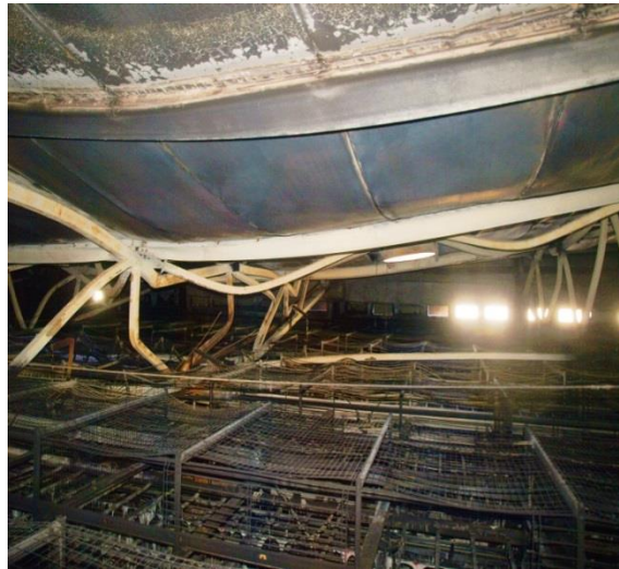
Рис. 1. Повреждения потолочного перекрытия и конструкций в помещении
